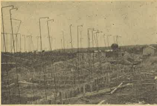
◆ 公営住宅建設工事 7月から総額800万円で工事が進められております。 建設場所は水元町で簡易耐火構造平屋建14戸、その内訳は1種6戸、2種8戸です。 9月竣工予定 (工事中の公営住宅)
